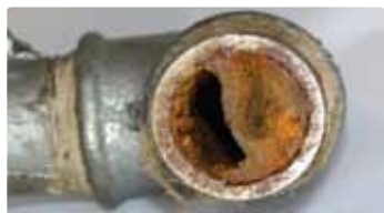
Tuyau présentant des dépôts de calcaire
